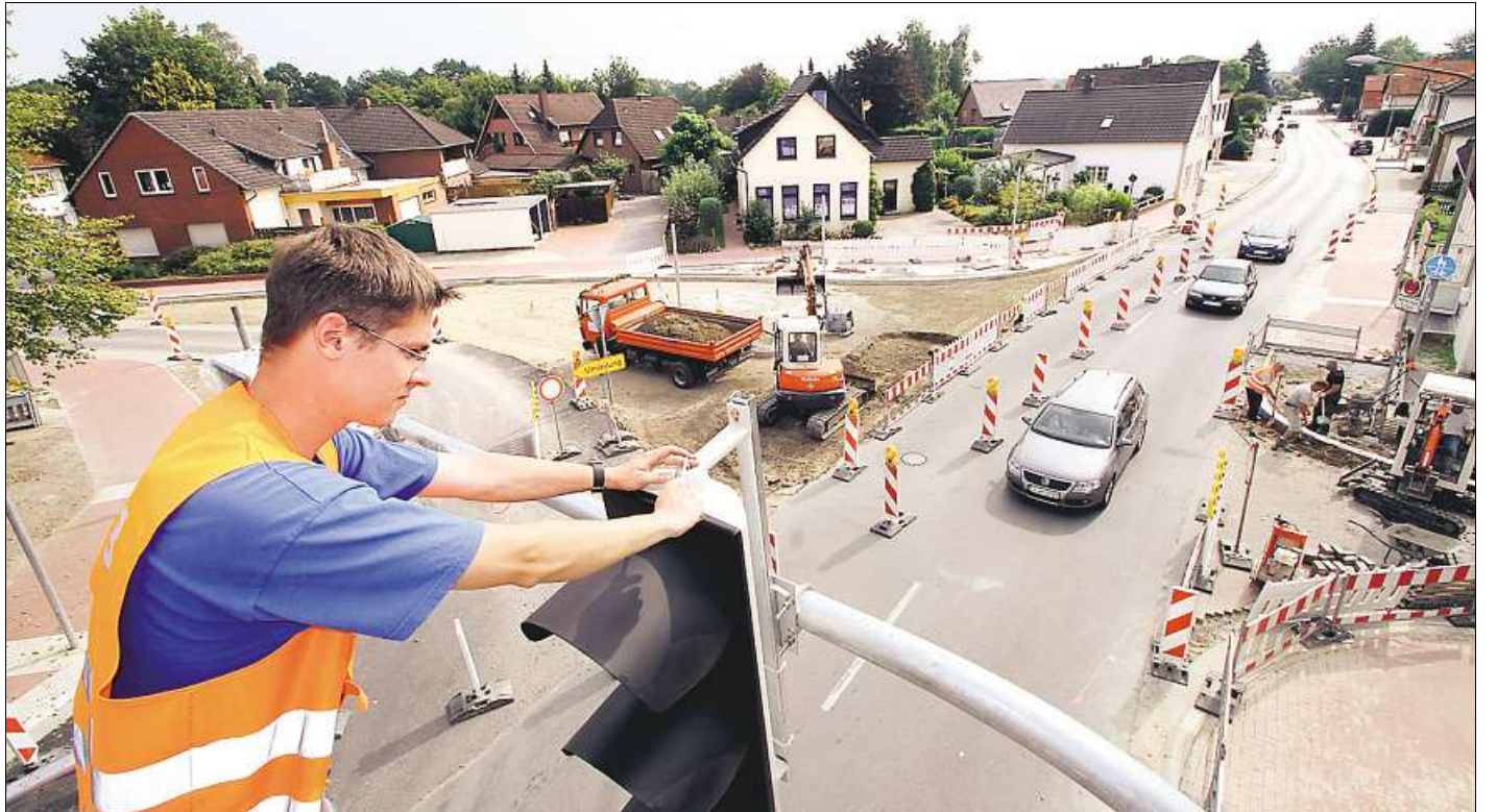
Guter Überblick: André Sommer von einer Oldenburger Firma beim Installieren der neuen Ampelanlage.
